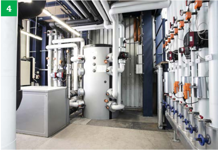
Heizkreisverteiler mit Pufferspeicher
